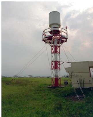
Esempio di stazione TACAN
